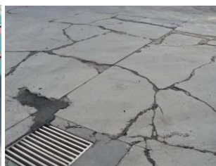
Bê tông nứt và gãy
