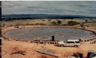
KÍN NƯỚC Bồn nước
